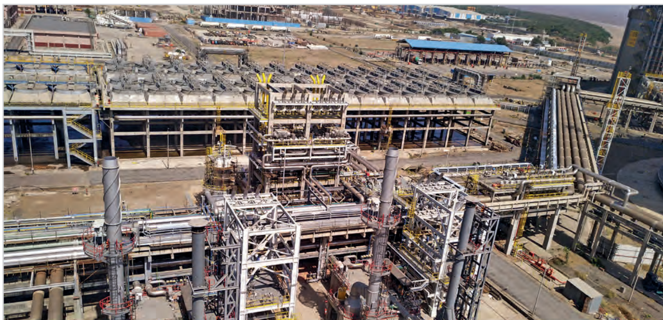
Regas capacity expansion at Dahej LNG Terminal
